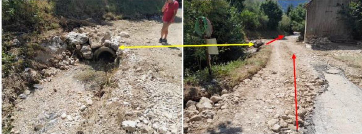
Figure 56 : engravement de la buse amont du hameau de Mont-Derrière (ONF-RTM, 2022).
