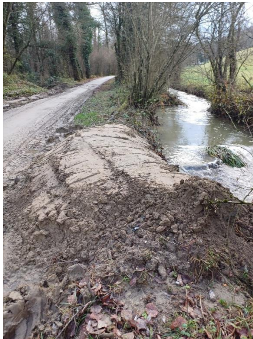
Figure 31 : brèche rebouchée en rive droite du Boiran, Rumilly (SMIAC, 2024).
