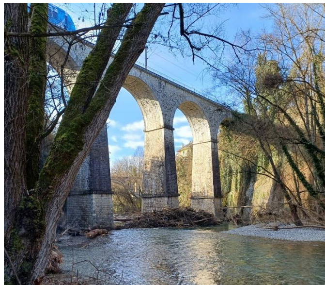
Figure 19 : embâcle sous le pont de la SNCF (SMIAC, 2024).
