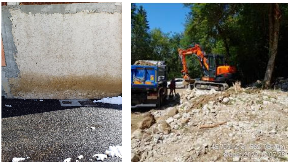
Figure 57 : A gauche : marques du passage de la crue au cœur du hameau de Mont-Derrière (SMIAC, 2023). A droite : engravement de la buse amont du hameau de Mont-Derrière (ONF-RTM, 2022).
