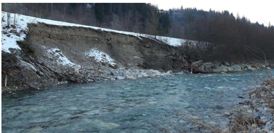
Figure 14 : digue de l'étang du Châtelard, post-crue (SMIAC, 2022).
