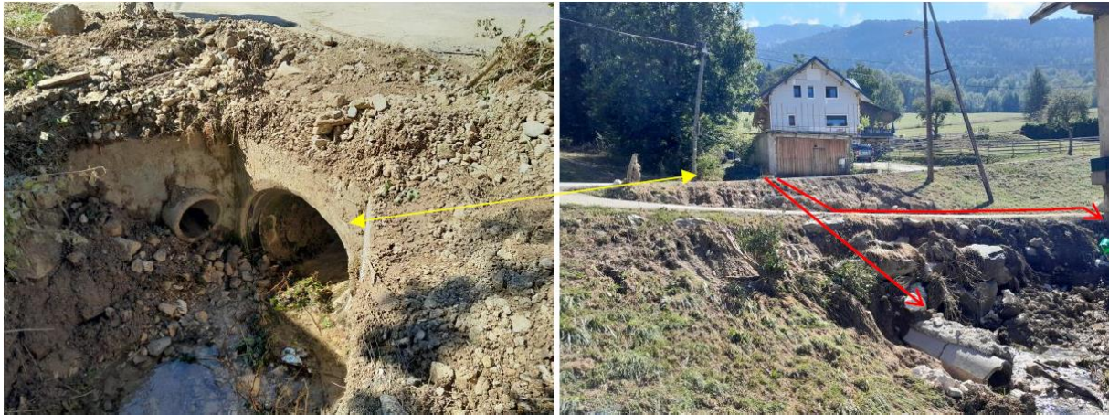
Figure 54 : dégâts au hameau de Villard-Derrière (ONF-RTM, 2022).
